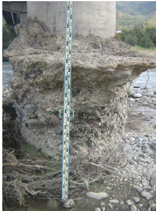
Фото 1. Одна из размывших опор существующего трубо-моста близ Натахтари
